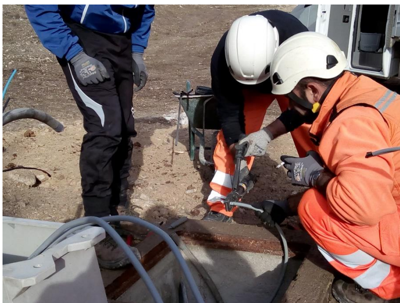
Messa a terra del neutro su contenitore C3M
